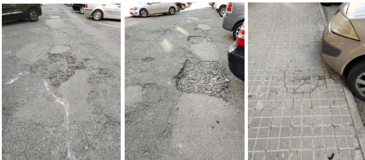
El grave deterioro de la calzada y de la acera ha sido denunciado al director del Distrito
