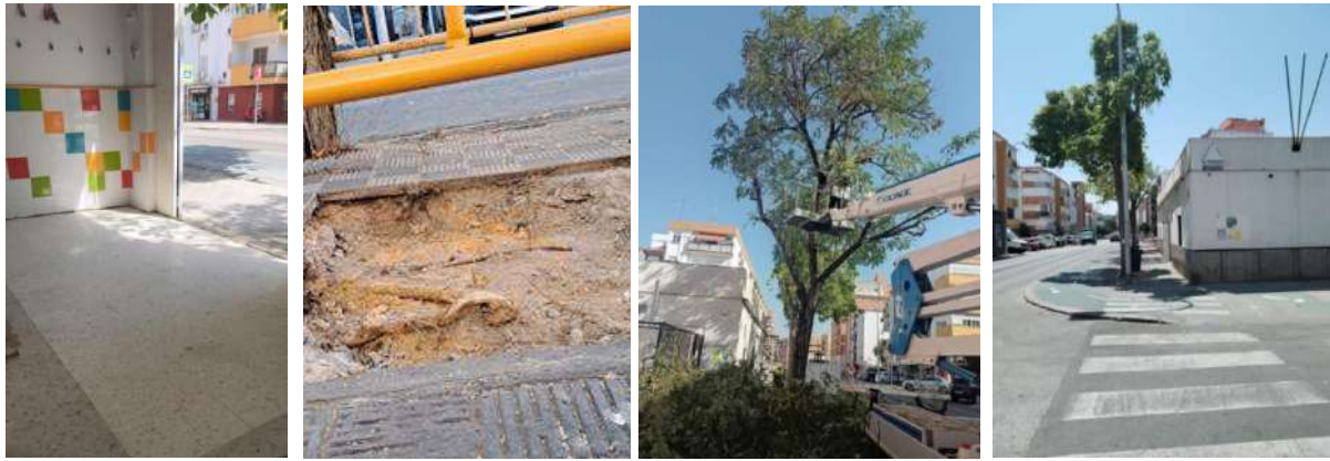
Reparación de la solería en el local provocada por las raíces de los árboles qué por fin se han podado y acondicionado parcialmente
